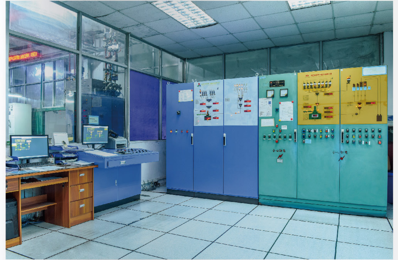
黑色線BB100L二樓PLC控制室
